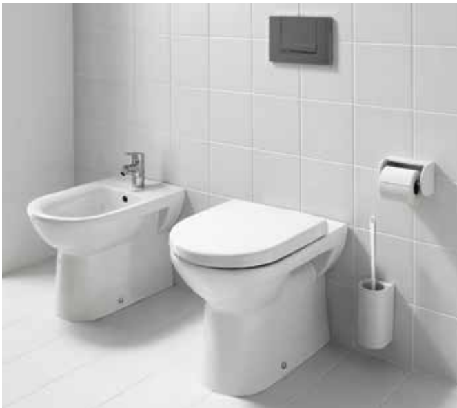
WC et bidet au sol adossés au mur.
